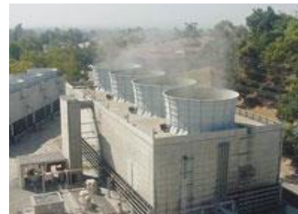
torri di raffreddamento/ condensatori evaporativi
